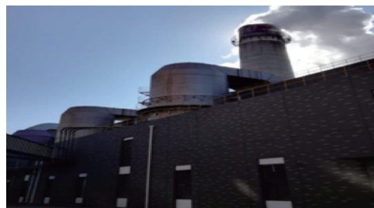
图：脱硫除尘设备
