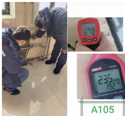
图: 公司工人为暖气通道排气 & 学生宿舍测温结果
