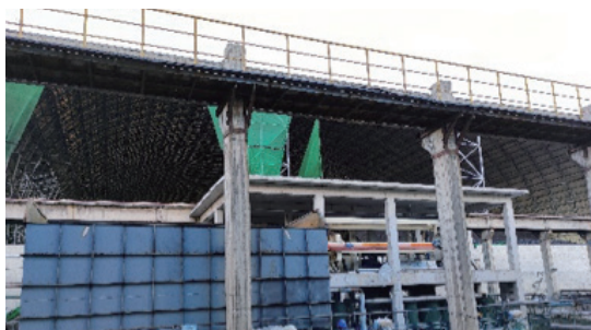
图：脱硫废水治理工程
